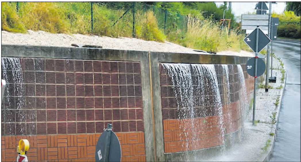
Große Wassermengen traten während des Starkregenereignisses aus dem Bereich der erneuerten Drainageleitung in der Bachstraße aus.
