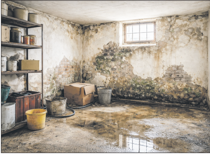
Feuchte Keller schaden der Bausubstanz und der Gesundheit der Hausbewohner. Das Mauerwerk sollte professionell getrocknet und dann so abgedichtet werden, dass es dauerhaft vor Feuchtigkeit geschützt ist. Foto: KI-assistiert
