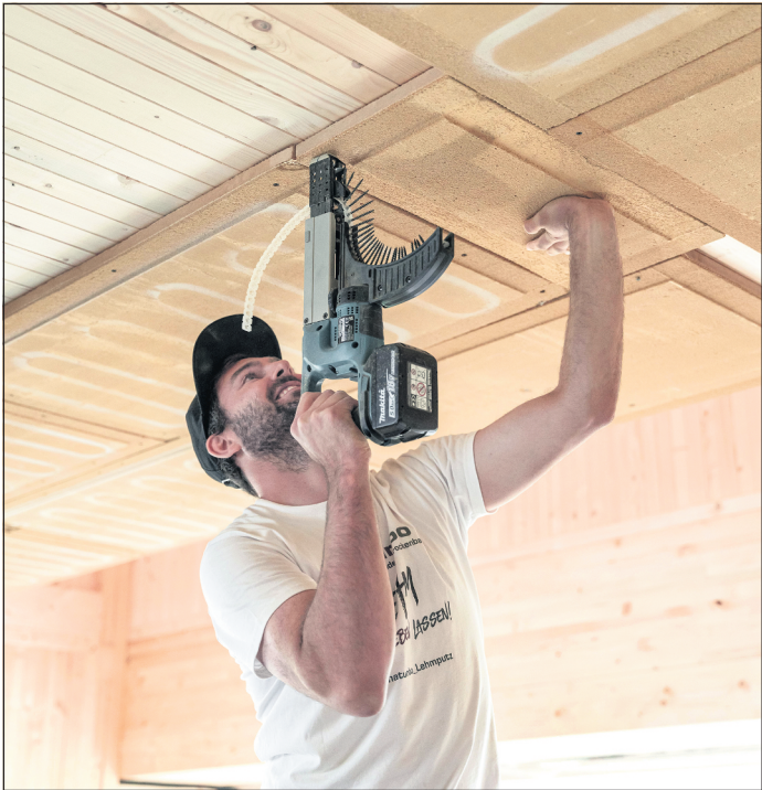
Deckenheizungen mit Lehmputz-Trockenbauplatten sind ideal für den Umstieg auf eine Wärmepumpe im Eigenheim. Versierte Heimwerker können sie ohne weiteres selbst einbauen. Foto: djd/Naturbo
